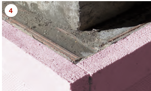
4 Die Konsolen werden mit Ziegelstürzen (115/113) überbrückt und anschließend gedämmt. Nach Auftrag einer Mörtelausgleichsschicht kann mit den Mauerarbeiten begonnen werden.
