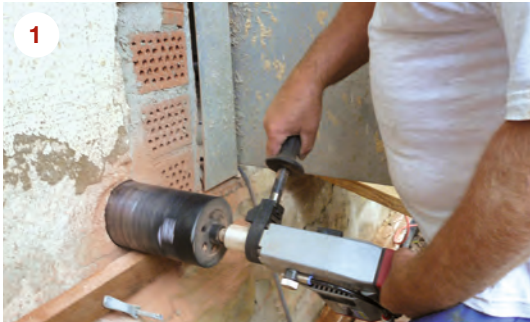
1 Erstellen des Bohrlochs (d = 125 mm) in der Bestandswand mit handgeführtem Bohrgerät. Zur Führung der Bohrkronen wird vorher eine Schablone angebracht.
