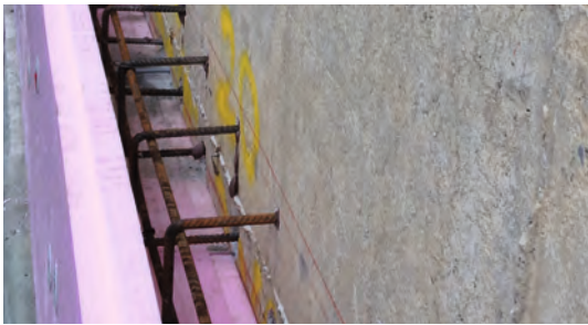
Bild 1: Nachdem die Bewehrung am aufgerauten Bestand angebracht ist, kann die Perimeterdämmung montiert werden. Diese wird geklebt und zusätzlich gedübelt (z. B. mit Ejothem STR U 2G).
